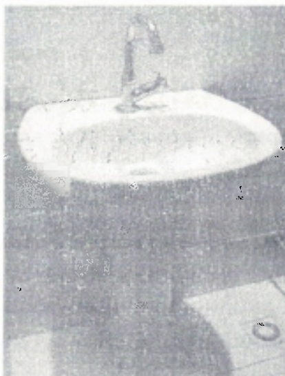
Figura 4 - Lavatório com coluna
