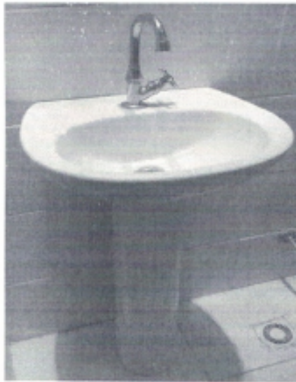
Lavatório com coluna
